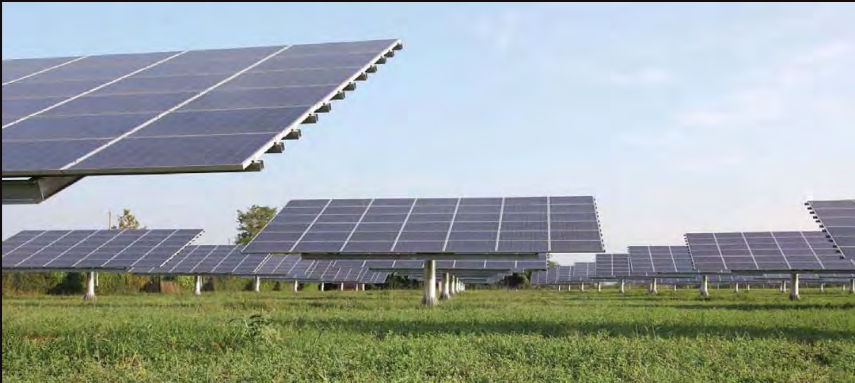
Spirano centrale fotovoltaica
